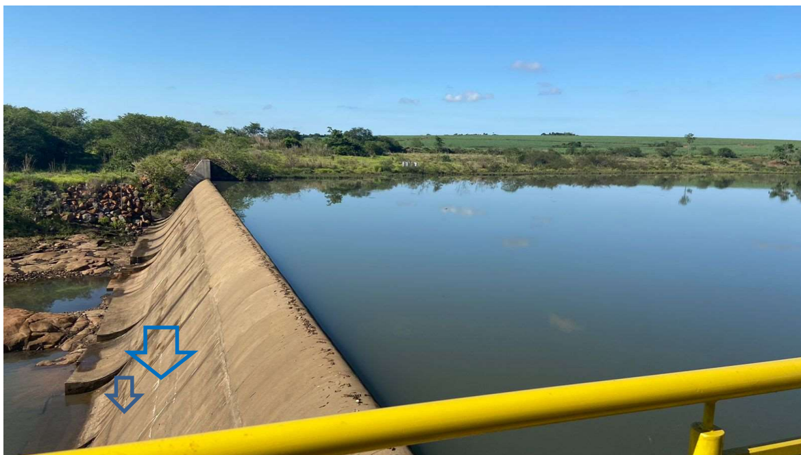
Figura 32 – Pequenos pontos com presença de carbonatação na superfície do vertedouro, aparentemente estabilizada
