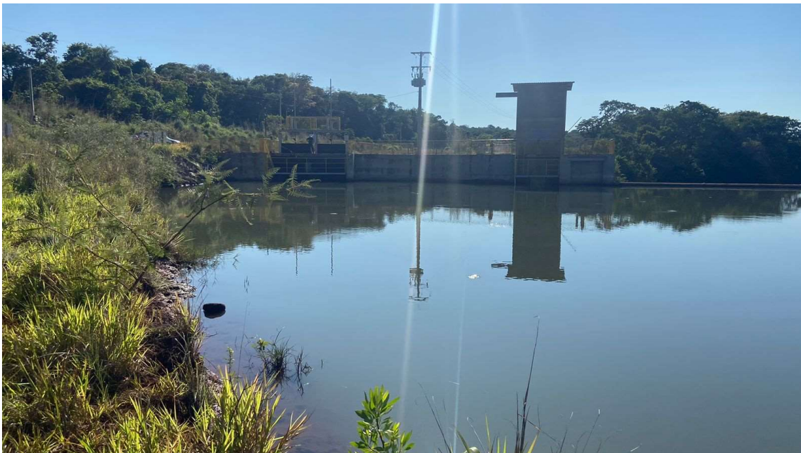
Figura 18 – Visão a partir da margem esquerda, foco eixo da barragem e e estruturas
