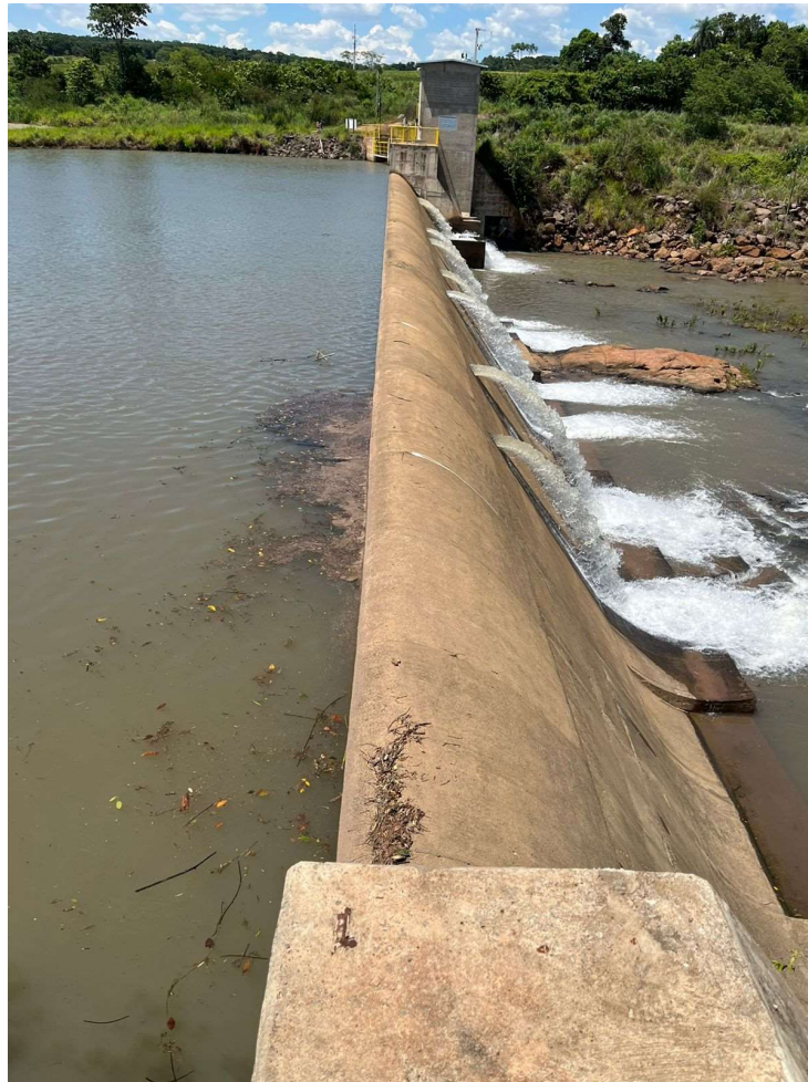
Figura 16 – Visão a partir da margem direita, foco eixo da barragem e margem esquerda (margens bem protegidas com enrocamento de pedras e vegetação)
