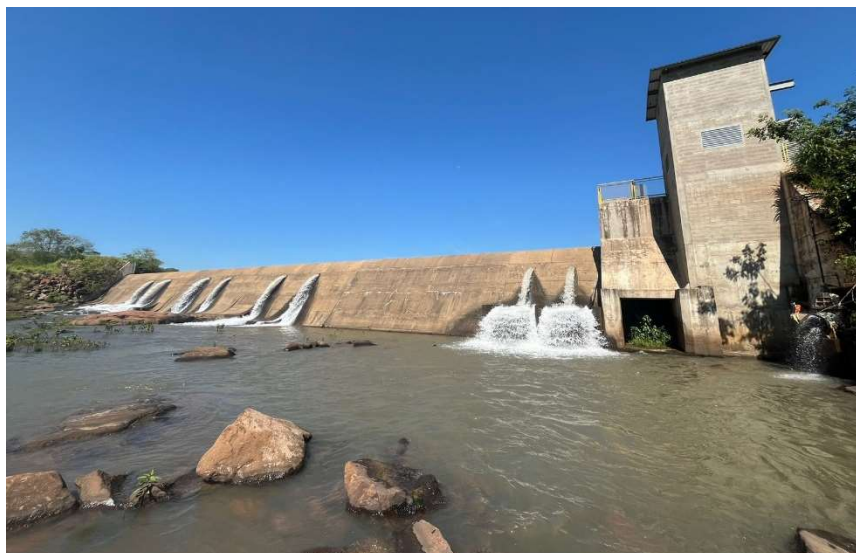
Figura 22 – Visão a partir da margem esquerda, vertedouro, jusante da barragem e margem direita
