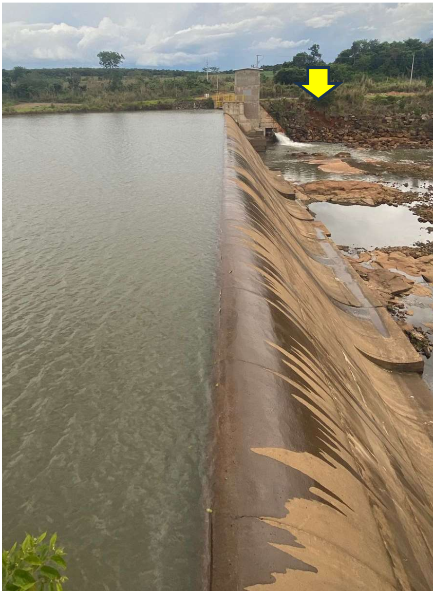
Figura 03 – O surgimento de erosões superficiais e a ocorrência de deslocamentos da superfície dos taludes (escorregamento), originado pelo saturamento superficial e pela diminuição da resistência ao cisalhamento do material(RISR2022)
