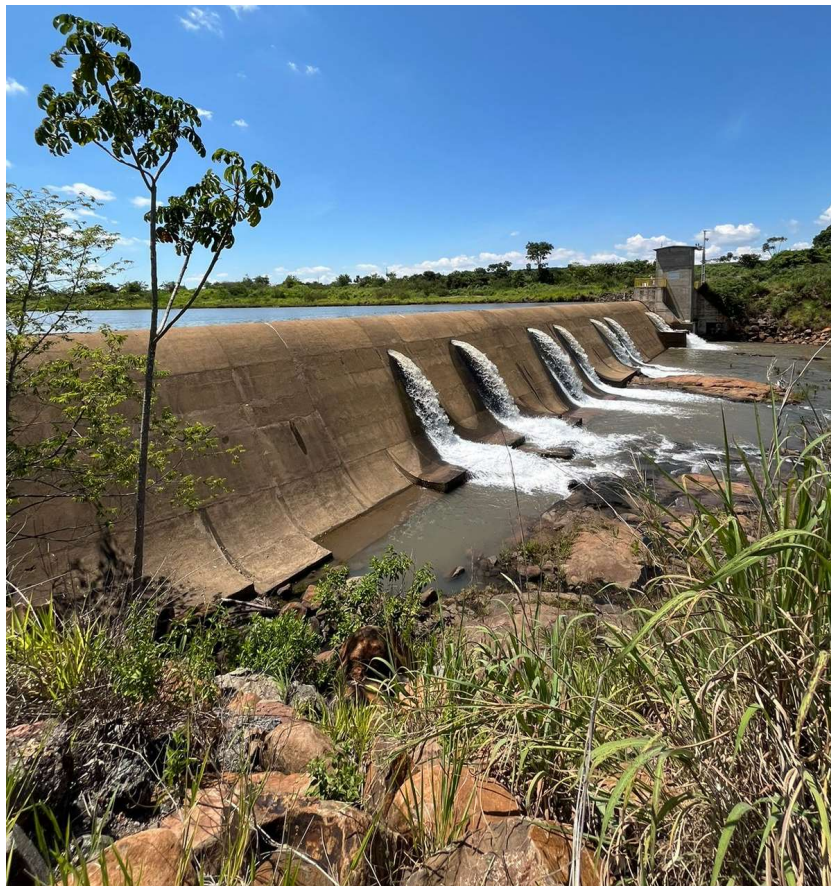
Figura 21 – Visão a partir da margem direita, foco jusante da barragem e margem esquerda
