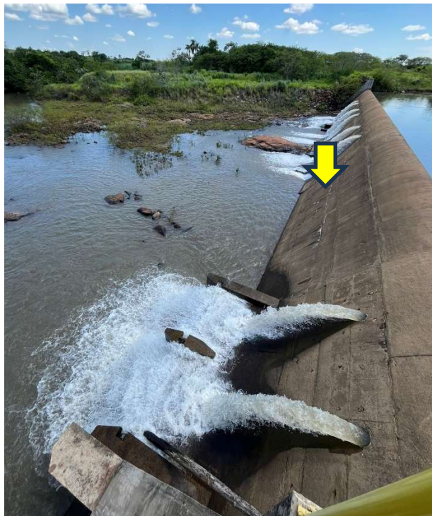
Figura 02 – Pequenos pontos com presença de carbonatação na superfície do vertedouro, aparentemente estabilizada (RISR2024)
