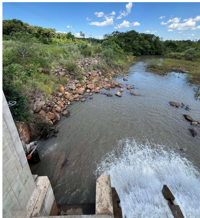
Figura 24 – Visão a partir descarga de fundo, jusante da barragem e enrocamento margem esquerda
