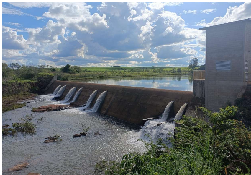
Figura 26 – Visão a partir da margem esquerda, foco eixo da barragem jusante e margem direita
