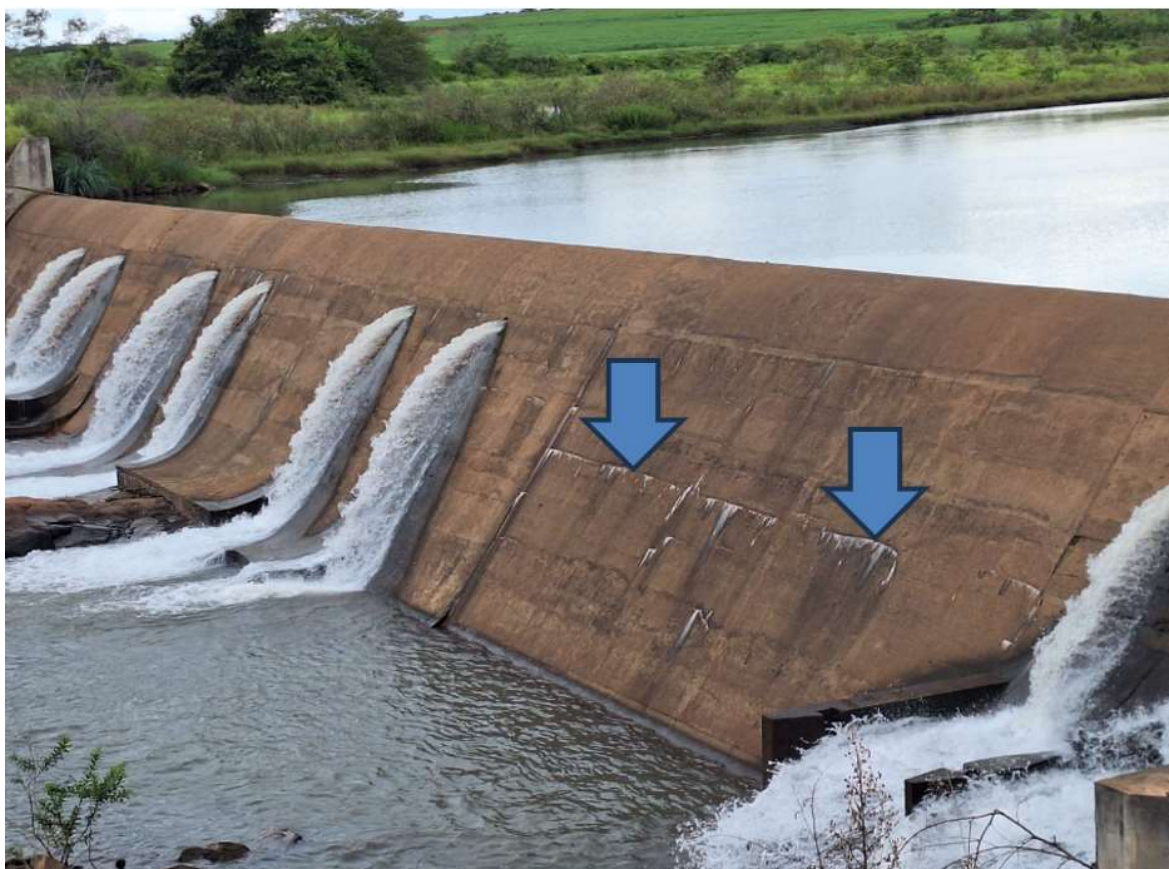
Figura 3 – Pequenos pontos com presença de carbonatação na superfície do vertedouro identificada RISR2022, aparentemente estabilizada (RISR2025)
