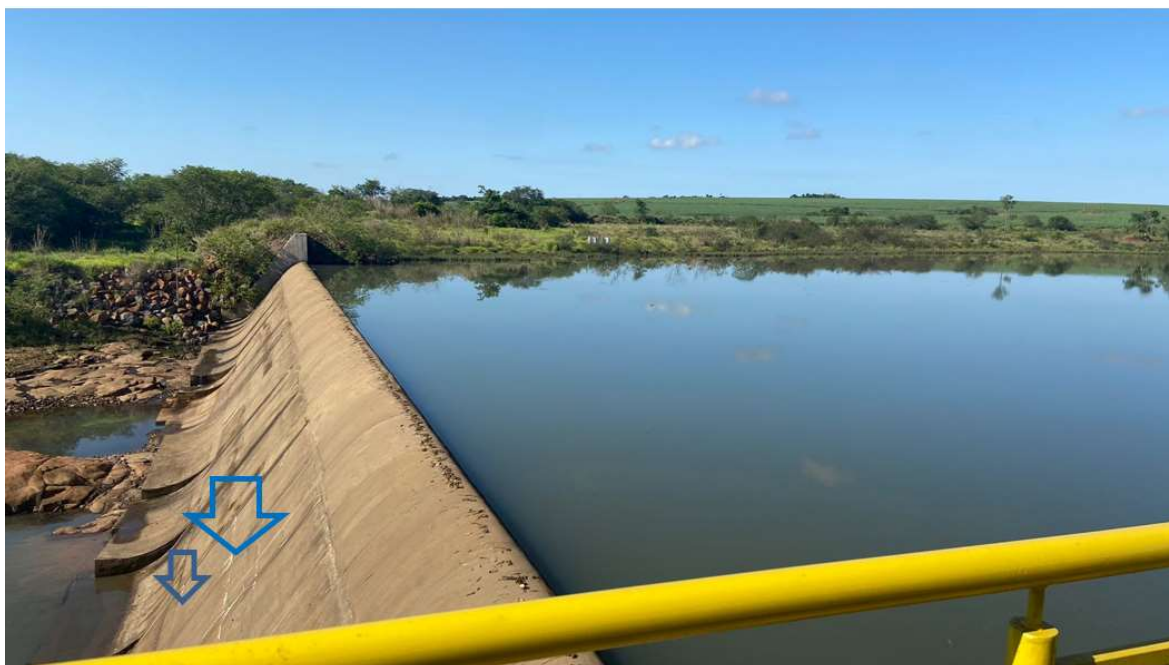
Figura 1 – Pequenos pontos com presença de carbonatação na superfície do vertedouro, aparentemente estabilizada (RISR2022)
